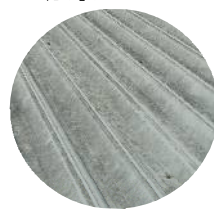
▶ ほこりなどで汚れた屋根
