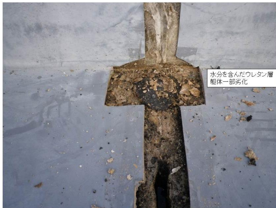
ウレタン塗膜防水層内の水分状況写真
